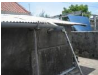
雨水の集水(雨樋より集水)
